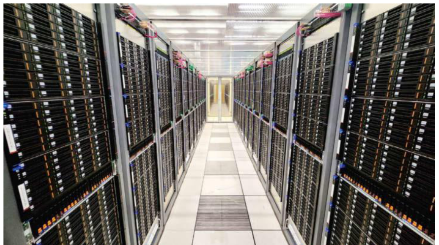
In zwei Rackreihen stecken 50 Petabyte, ein Drittel des gesamten Speichervolumens EOS ALICE O2 Storage Systems im Meyrin-Rechenzentrum.
